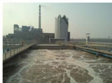
汇胜集团1万m 3 /d污水处理工程
