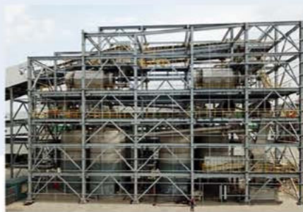
木片水洗+循环水处理系统
