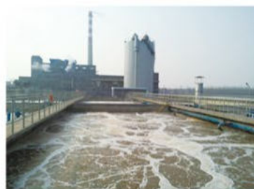
汇胜集团1万m 3 /d污水处理工程
