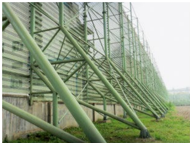
图5 北方某厂木片堆场17米网高防风抑尘网
