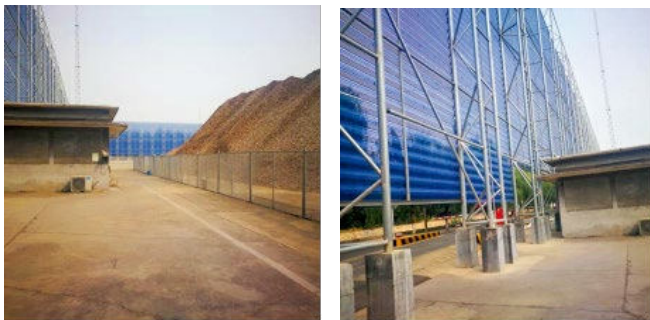
图6 北方某厂木片堆场25米网高防风抑尘网
