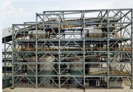
木片水洗+循环水处理系统
