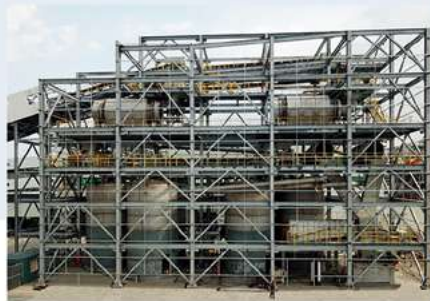
木片水洗+循环水处理系统
