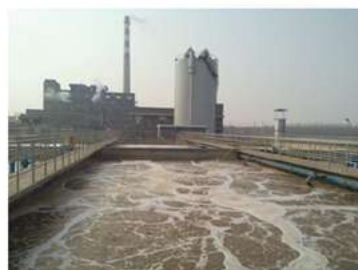
汇胜集团1万m 3 /d污水处理工程
