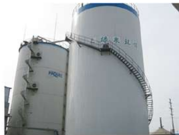
山东世纪阳光纸业2.5万m 3 /d污水处理工程
