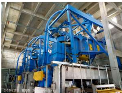
木片筛 (1000m 3 /h, 700m 3 /h) + 再碎机 (110m 3 /h)
