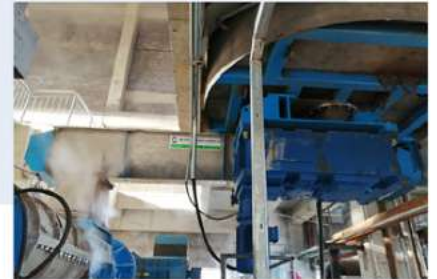
预蒸仓底部出料装置
